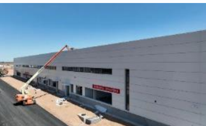
正泰新能盐池基地
