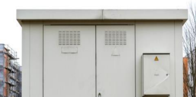
电力行业解决方案 国网湖南低压精品台区项目
