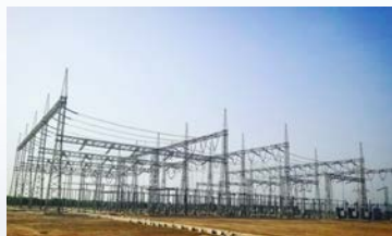
巴基斯坦moro500kV变电站
