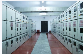
大庆油田 (箱变、开关柜)
