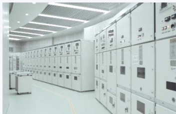
中央电视台 (开关柜)
