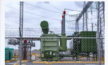
墨西哥雷诺萨风电场400kV变电站 (主变)
