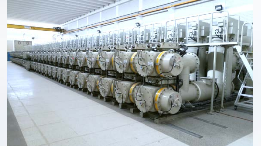
科威特132kV设备集成项目 (GIS、主变)
