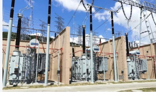
国网舟山500kV变电站 (主变)
