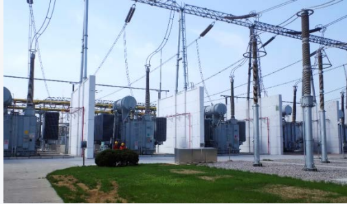
国网石家庄石北500kV变电站 (主变)
