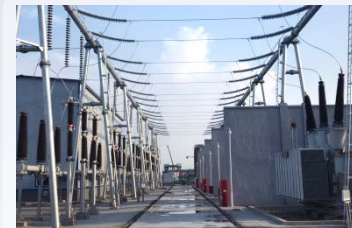
内蒙古通威220kV变电站 (EPC)
