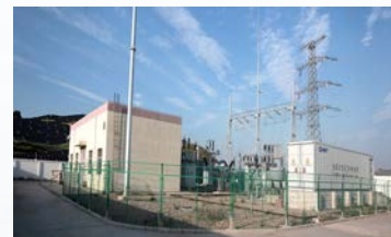
山西省偏关县110kV光伏升压站
