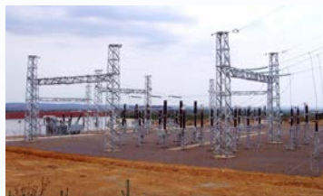
刚果金 220kV SMC变电站
