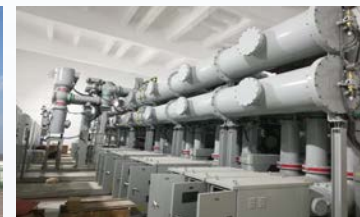
亿鼎220kV输变电工程
