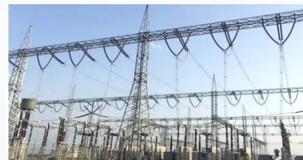
巴基斯坦Moro 500kV变电站 (EPC)
