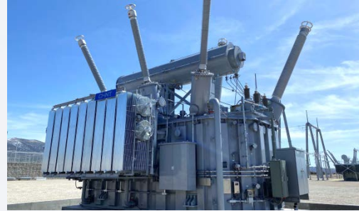
美国NV-Energy 525kV变电站 (主变)
